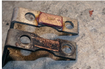
Unten Schrott, oben neu: Durch Auflöten einer neuen Kontaktplatte lassen sich die meisten verbrannten Kontakte retten
