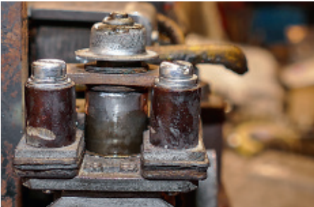
Prallspiel: Um die Kontakte kraftvoll zu schließen, ziehen die Relaiskontakte gegen eine Feder. Nach dem Aufliegen der Kontakte muss sich die ...
